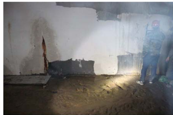
(d) Structural decoration layer seriously damaged
